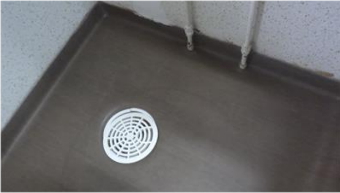
Rör genomföring i duschgolvet
