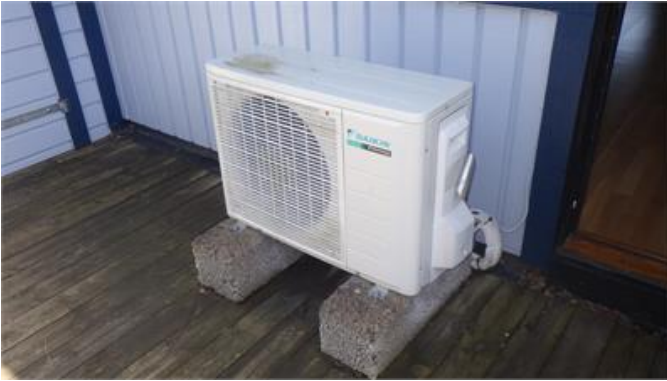
Luft/luft värmepumpens utomhusdel vid huslivet
