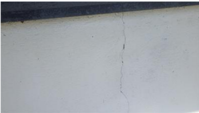
Spricka i sockeln
