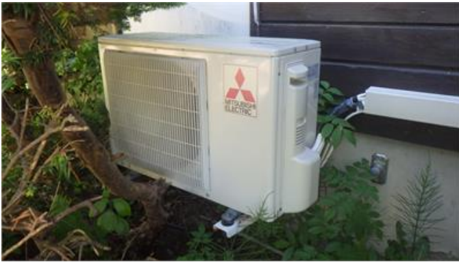
Värmepumpens utomhusdel vid fasaden
