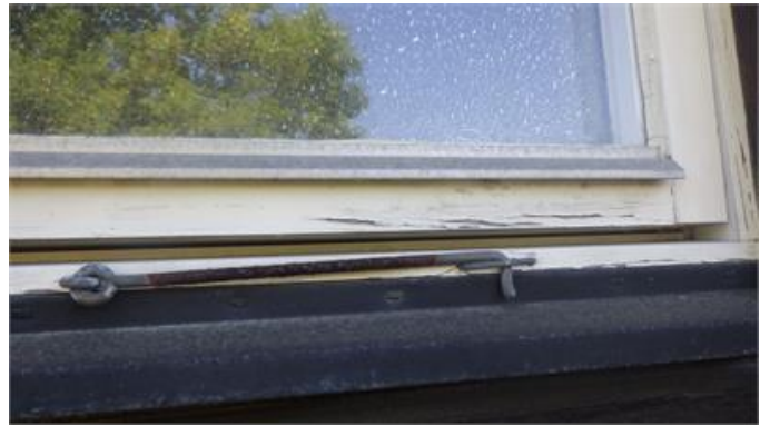
Fönster med målning/underhållsbehov
